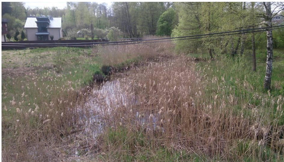
Foto 6. Langas gultnes sašaurinājums un aizaugums ar niedrēm, skats uz leju no Valsts autoceļa P1 tilta Kalngalē (PK61/07).
